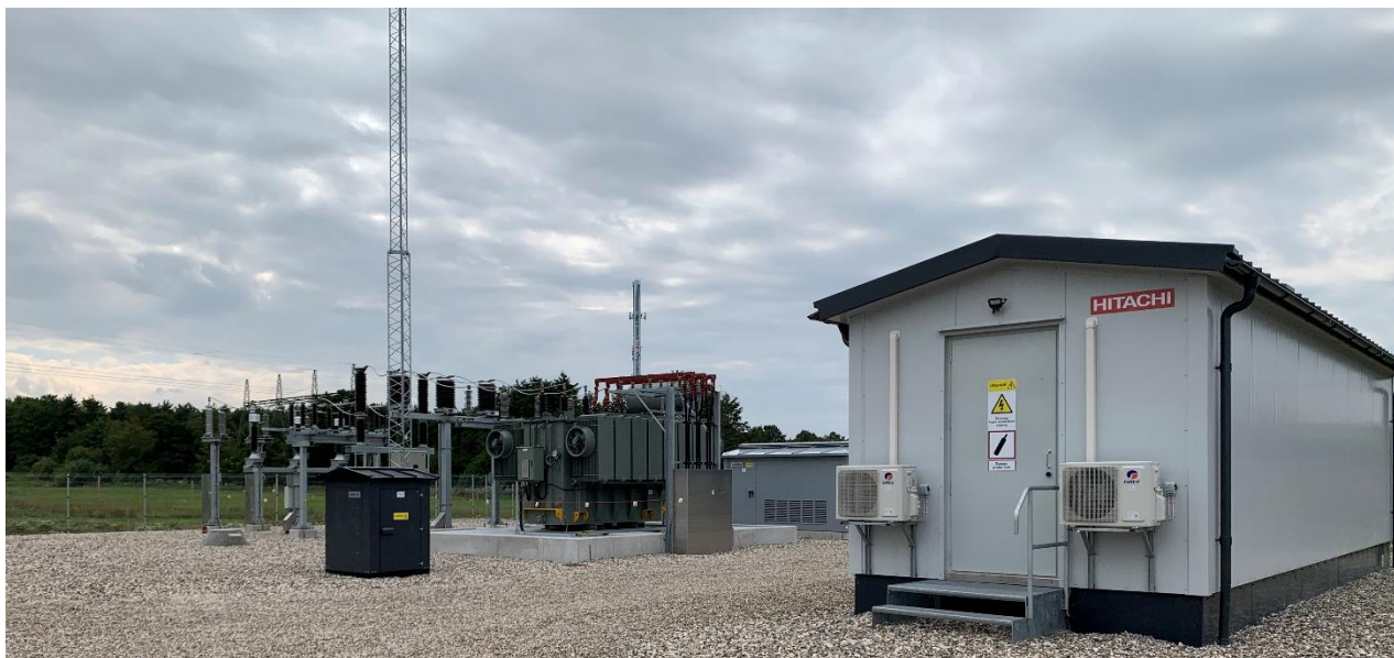
Figur 8: Eksempel på transformerstation i eksisterende anlæg. Installationens størrelse vil være afhængig af anlæggets kapacitet
